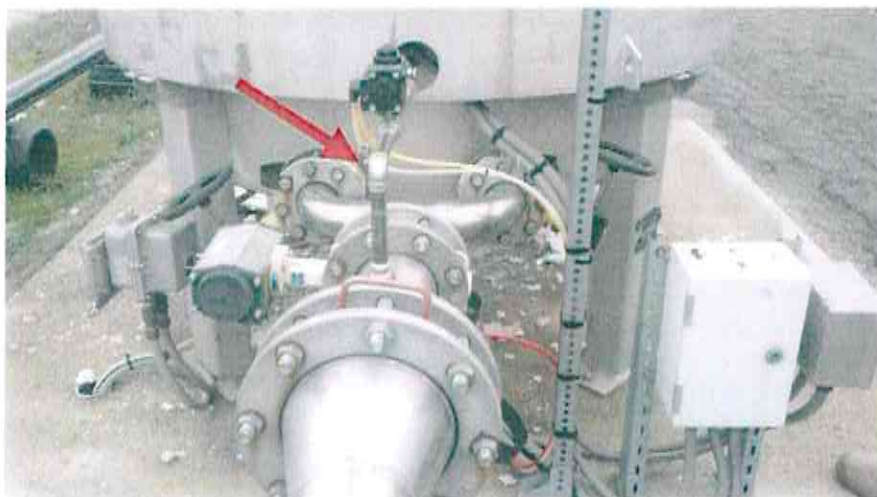
Figura 2 Gruppo controllo adduzione biogas.
