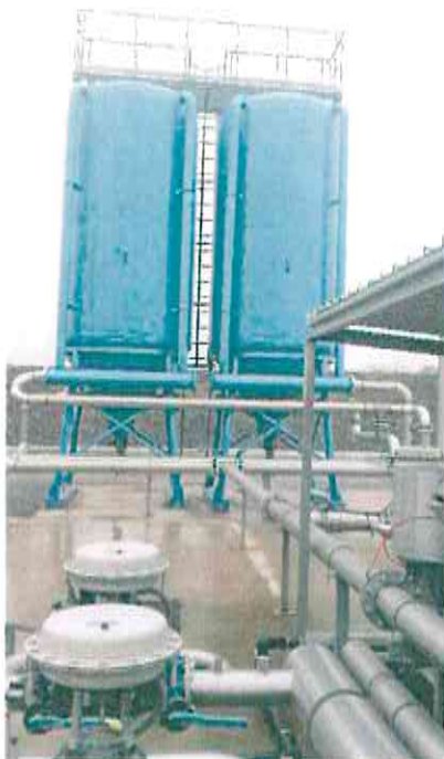
Figura 14 Silos deputati allo stoccaggio del carbone attivo deputato al trattamento del biogas dopo privazione dell'umidità.
