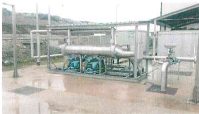
Figura 15 Impianto di aspirazione del biogas e gruppo di deviazione alla torcia di emergenza.
