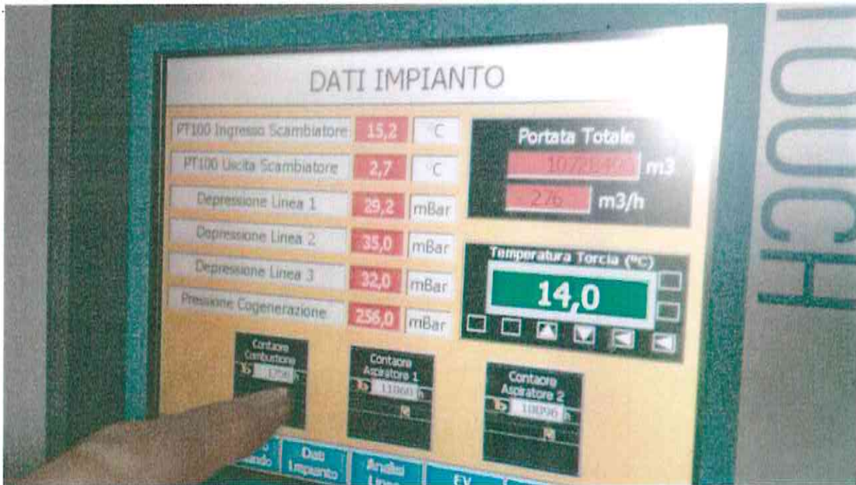
Figura 16 Particolare del pannello di controllo asservente il gruppo di cogenerazione che indica la portata del biogas in alimentazione al gruppo, al momento del controllo pari a 276 mc/h.
