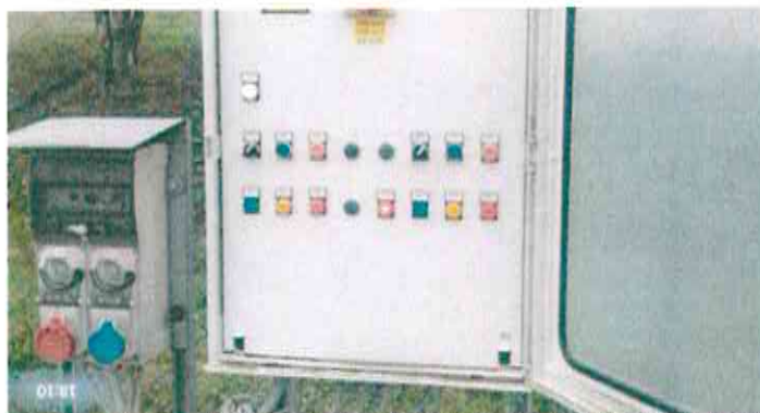
Figura 8 Vista del quadro posto in fronte al lotto 1, lungo il perimetro sud della vasca. La luce rossa corrisponde alla segnalazione di mancata alimentazione della pompa di pescaggio percolato, questo è dovuto allo sgancio di un interruttore magnetotermico a protezione della pompa stessa.
