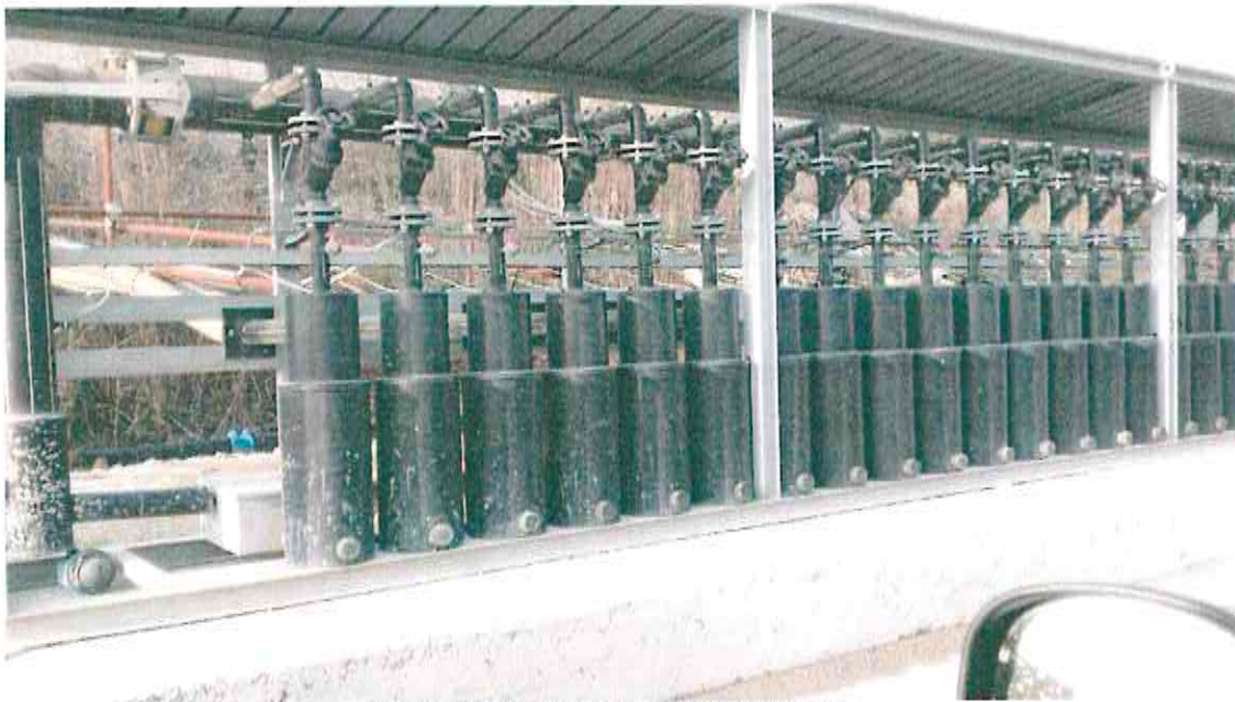
Figura 9 Sottostazione asservente lotto 1
