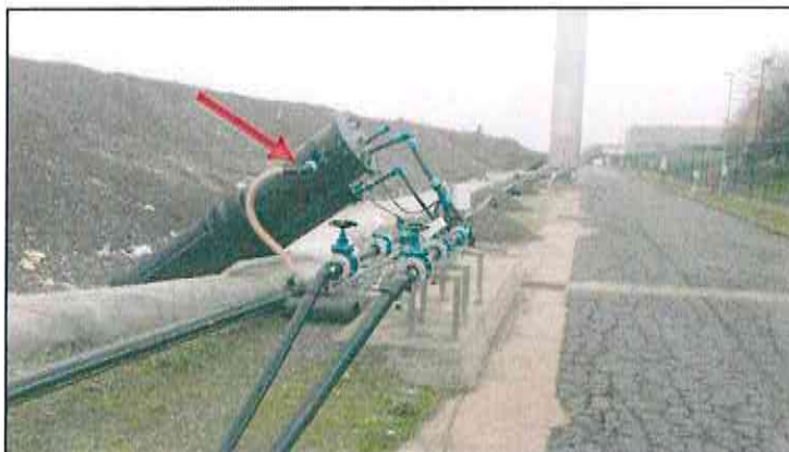
Figura 10 Vista di un pozzo di captazione del percolato. La freccia indica la tubazione che assicura l'aspirazione del biogas dalla rete mista biogas/percolato posta sul fondo della discarica.
