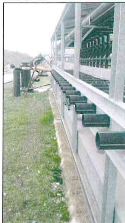
Figura 11 vista della parte posteriore della centrale sottostazione asservente il lotto 2. Si noti che solo due tubazioni sono collegate e sono quelle provenienti dalla rete di captazione dal fondo di discarica.
