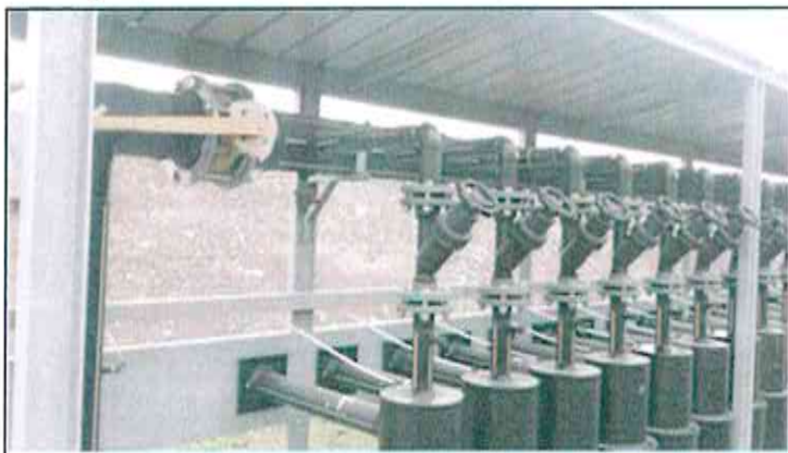
Figura 12 vista della parte anteriore della centrale sottostazione asservente il lotto 2.
